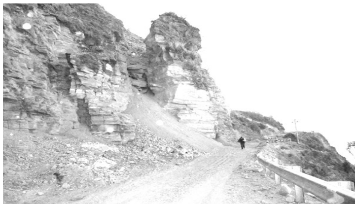
कर्णाली राजमार्ग अन्तर्गत कालिकोटको ताडी नजिकैको भिरमाजोखिमपूर्ण सडक ।
